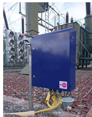
SIPP Node installato sulla vasca di raccolta olio del trasformatore.
