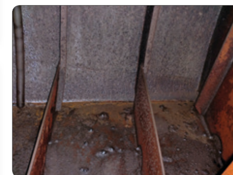
Formazione molto intensa di microorganismi nel serbatoio di gasolio
