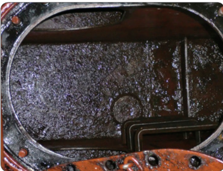
Dieseltank stark verunreinigt mit Schmutz, Schlamm und Wasser
